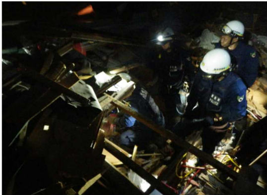
写真 5-6-5 倒壊建物内での活動状況
