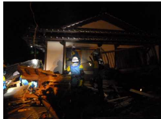
写真 5-28-1 2 階からの倒壊建物進入状況
