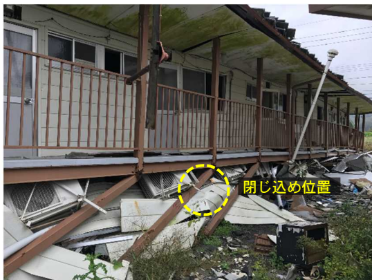
写真 5-31-1 建物倒壊状況 (平成28年10月26日撮影)
