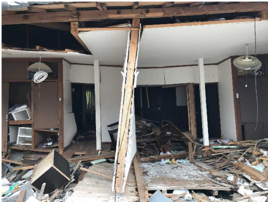
写真 5-39-1 建物倒壊状況 (平成 28 年 10 月 26 日撮影)
