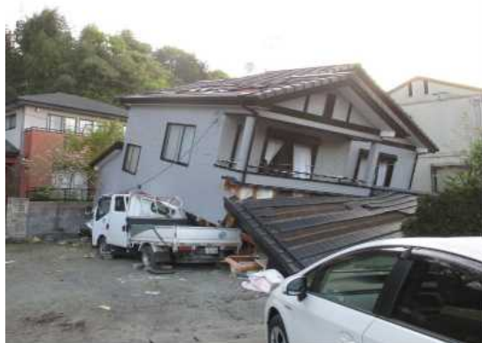
写真 5-16-1 建物倒壊状況
