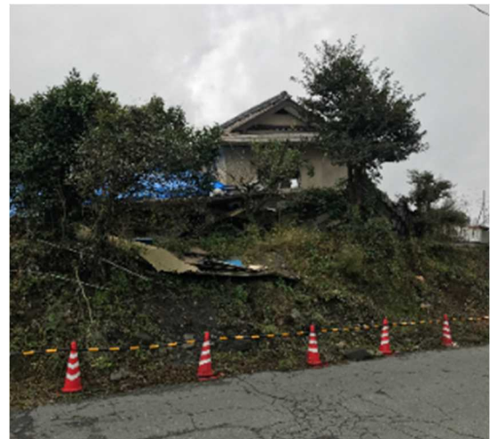
写真 5-21-1 建物倒壊状況 (平成28年10月26日撮影)
